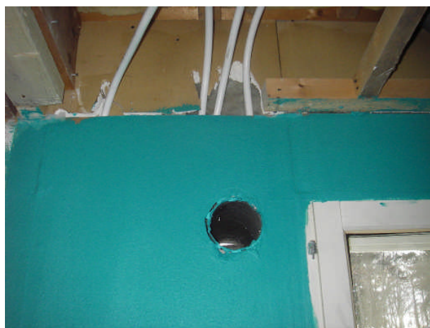
Raitisilmakanavan liitoskohta on vedeneristettävä.
