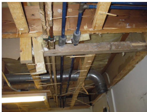
Katon alaslasku ja putkivedot.
